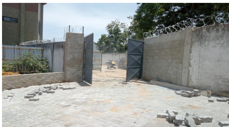
Muros 1 e 2 com instalação de portão metálico de acesso ao pátio da carceragem
