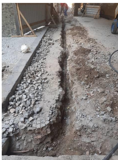
Escavação em todo o entorno do complexo judiciário para instalação do subsistema de aterramento com cabo de cobre nú
