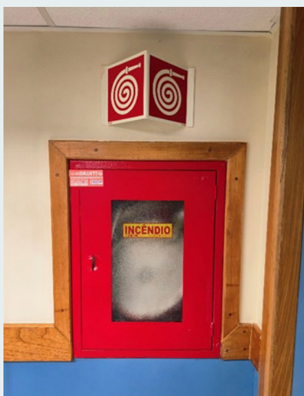
Centro Administrativo do Tribunal de Justiça – 4º andar: Hidrante e sinalização de emergência.
