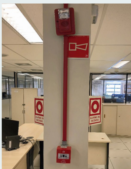
Centro Administrativo do Tribunal de Justiça – 4º andar: Acionador manual, sinalizador audiovisual e sinalização de emergência.
