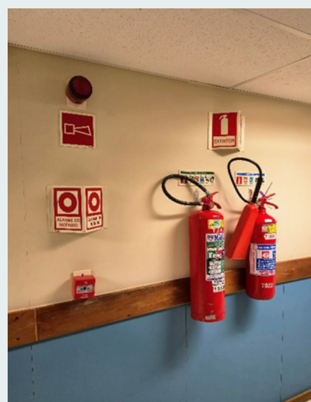
Centro Administrativo do Tribunal de Justiça – 4º andar: Extintores, sinalização de emergência, acionador manual e sirene.
