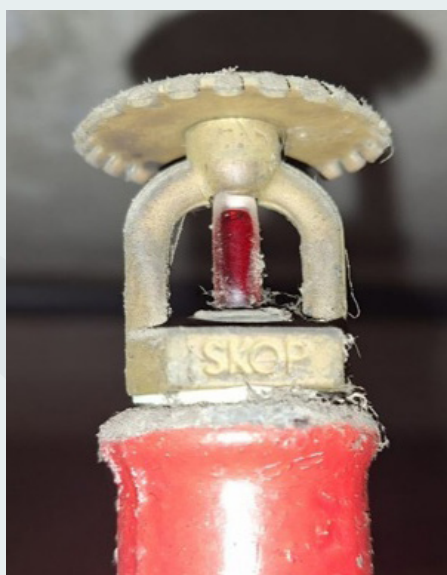
Fórum Regional da Barra da Tijuca da Comarca da Capital: Chuveiro automático (Sprinkler)
