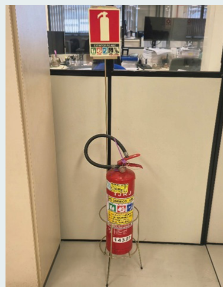
Centro Administrativo do Tribunal de Justiça – 4º andar: Extintor e sinalização de emergência.
