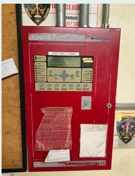
Centro Administrativo do Tribunal de Justiça – 2º andar Brigada de Incêndio: Painel de incêndio.
