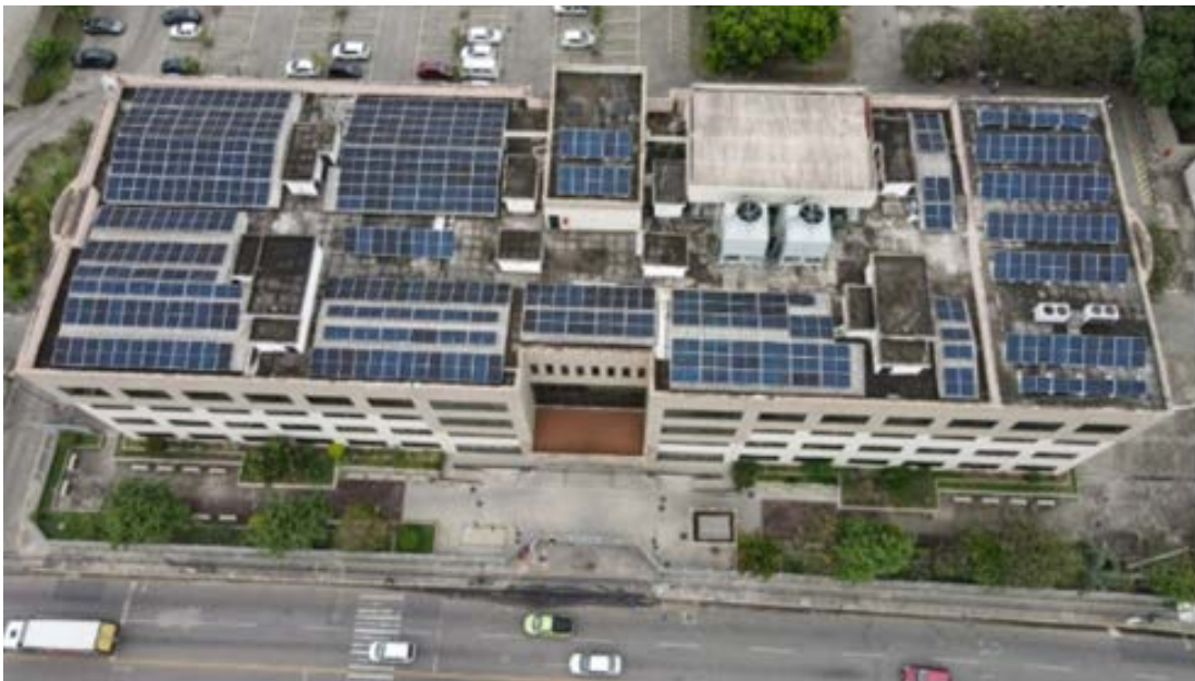
Placas fotovoltaicas instaladas
