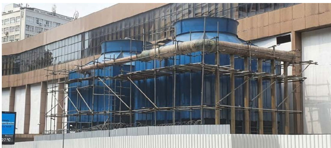
Torres de arrefecimento provisórias do Sistema de Refrigeração
