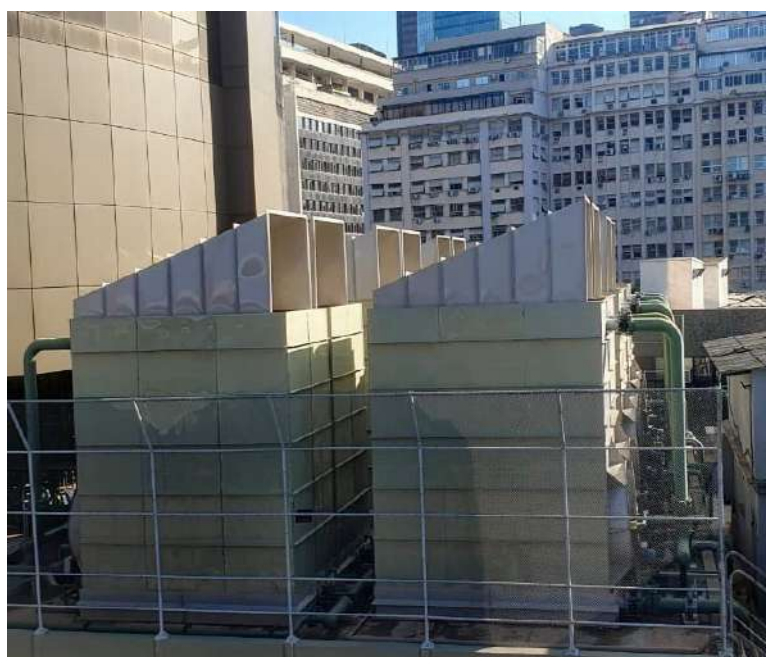
Novas e modernas Torres de Arrefecimento instaladas do Sistema de Climatização da Lâmina I
