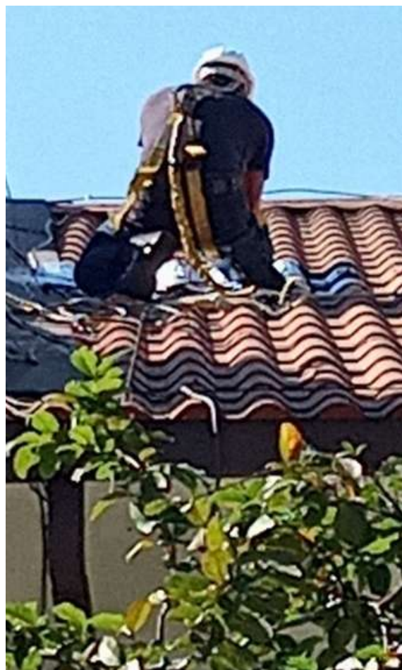
Ação corretiva realizada pela contratada por inconformidade detectada pela Direção do Fórum de Itatiaia e notificada por Carta-Fiscal
