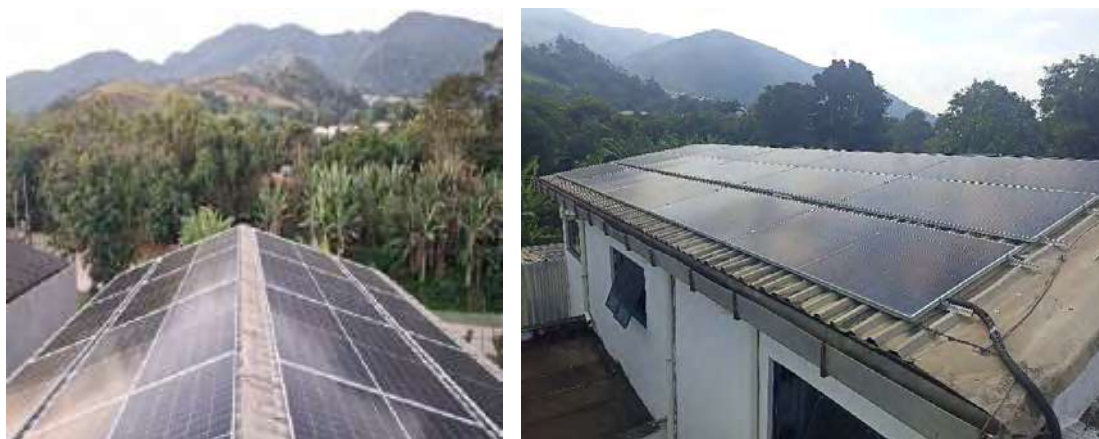
Placas fotovoltaicas instaladas
