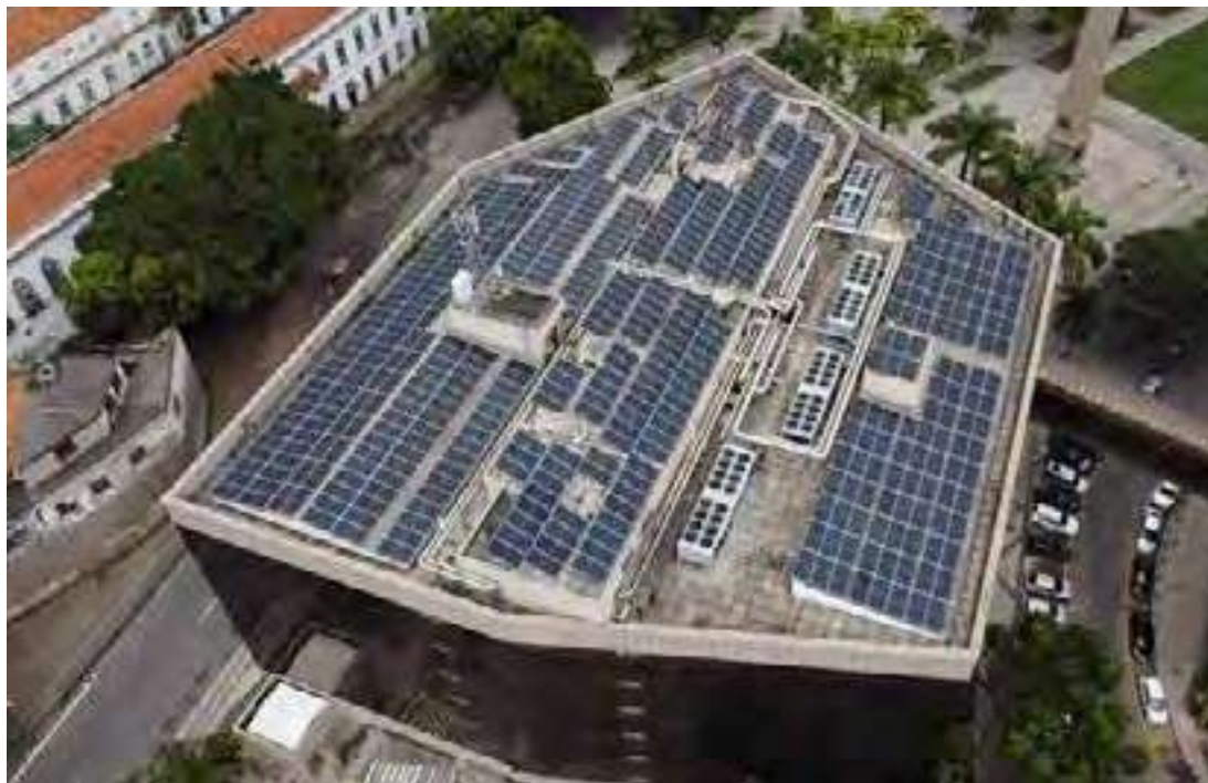
Placas fotovoltaicas instaladas / Fonte: Google Maps
