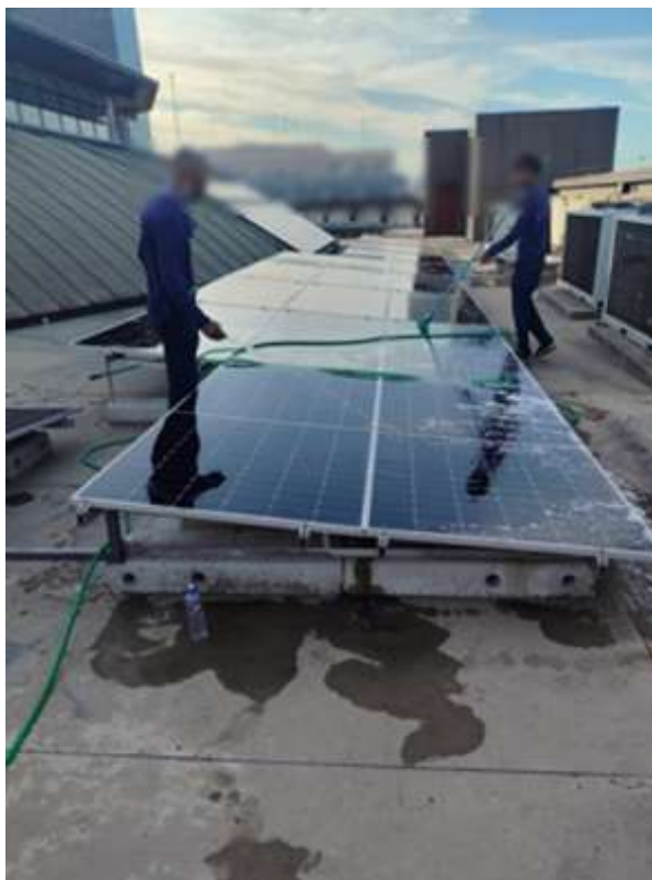
Ação corretiva realizada pela contratada na Lâmina I e II por inconformidade detectada pelo Serviço de Garantia (SEGAR) e notificada por Carta-Fiscal.
