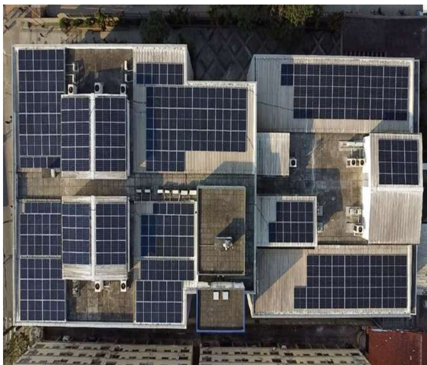
Placas fotovoltaicas instaladas
