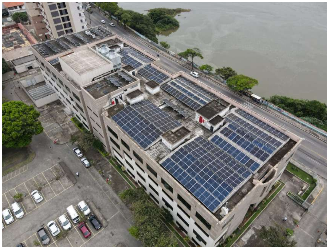
Placas fotovoltaicas instaladas
