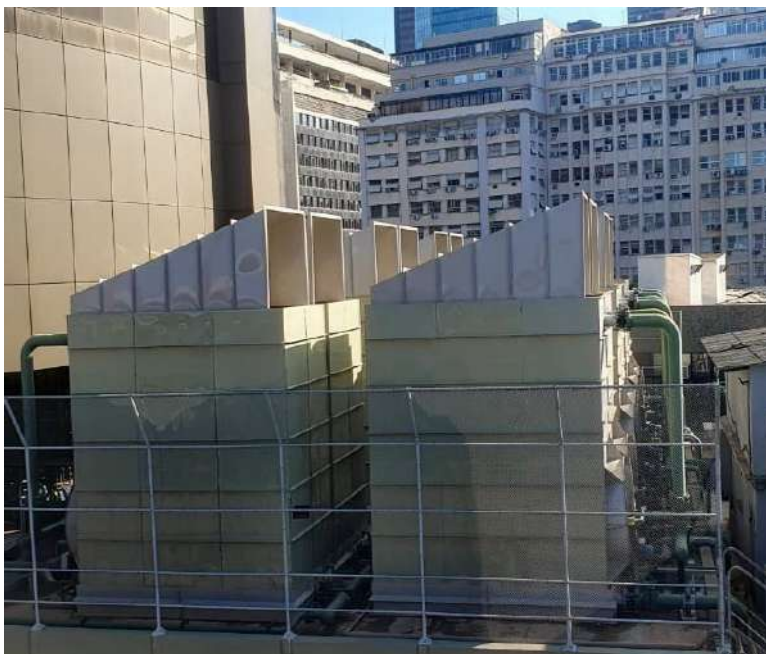
Novas e modernas Torres de Arrefecimento instaladas no Sistema de Climatização da Lâmina I
